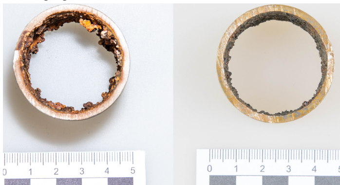
Rostavlagringar vattenrör före och 15 månader efter Bauer installerats
