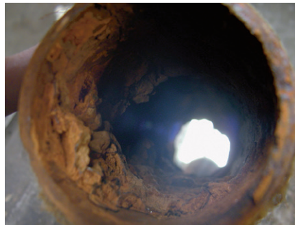
Galvaniserade kallvattenrör innan Bauer vattenbehandling har installerats
